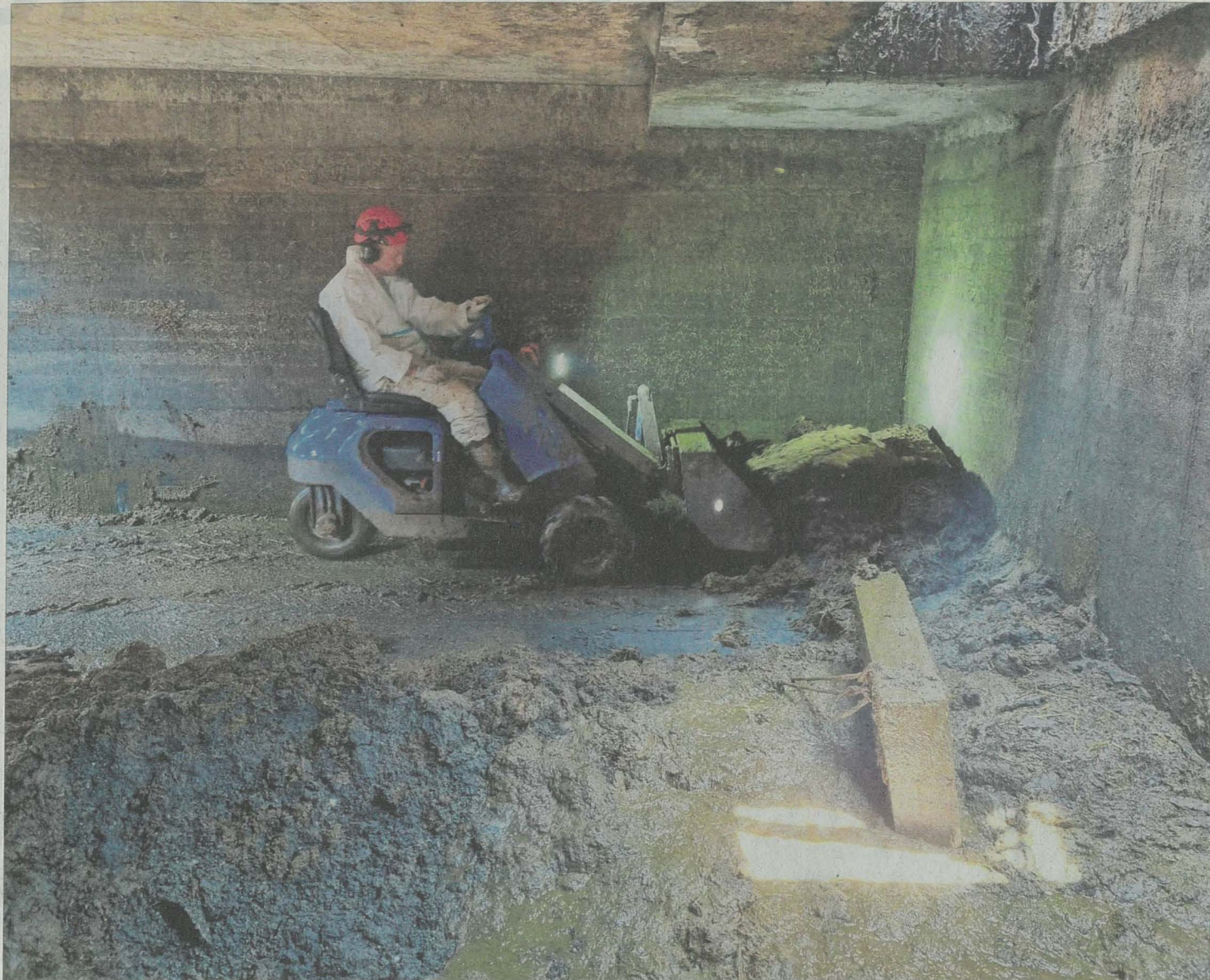
● Ein Einstieg darf nur bei laufender Lüftung und mit zwei Zusatzpersonen durchgeführt werden. (Bild: zvg)
