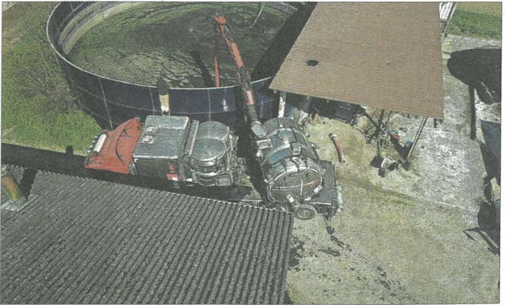
Auch offene Güllesilos können mit dem Saugbagger gereinigt werden.
